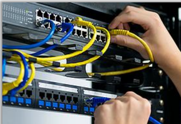
Conexão patch panel ao switch
