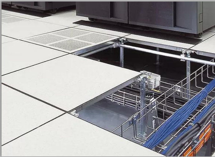
Piso elevado antiestático Calha aramada no entrepiso
